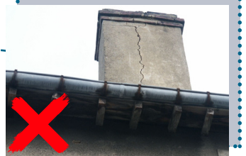
ETAT DU BATIS ET ACCES AU LOGEMENT
