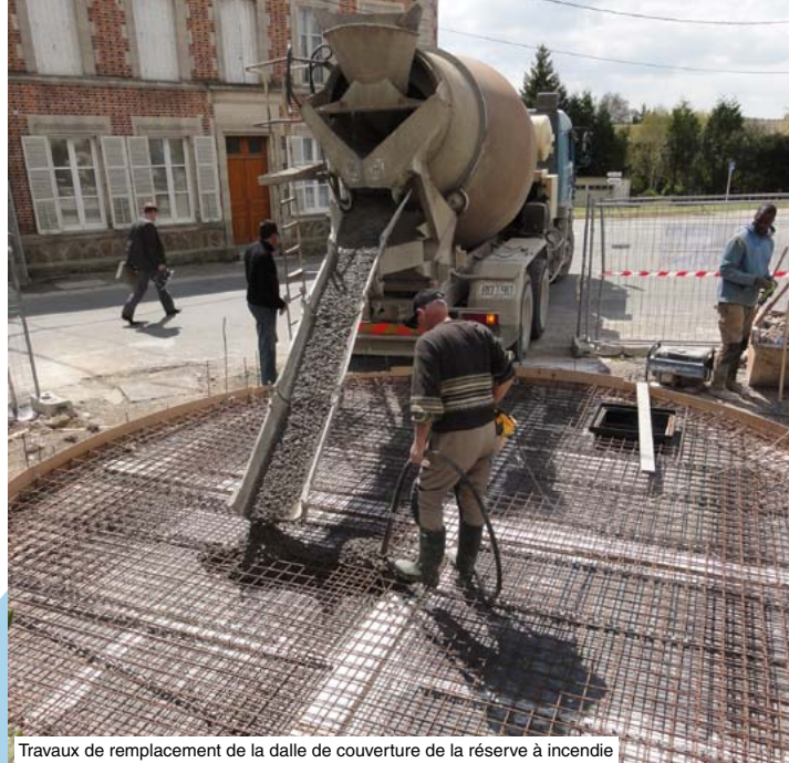
Travaux de remplacement de la dalle de couverture de la réserve à incendie
