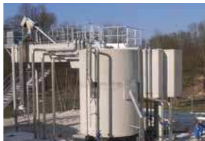
Les ouvrages de prétraitements (dégrilleur, dessableur et dégraisseur)
