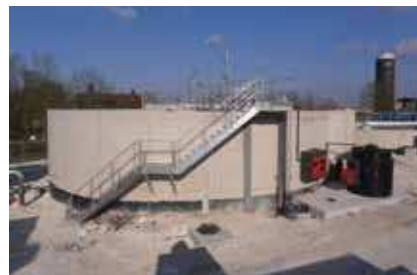
Le bassin d'aération d'un volume de 1 100 m 3 assure le traitement des eaux usées.
